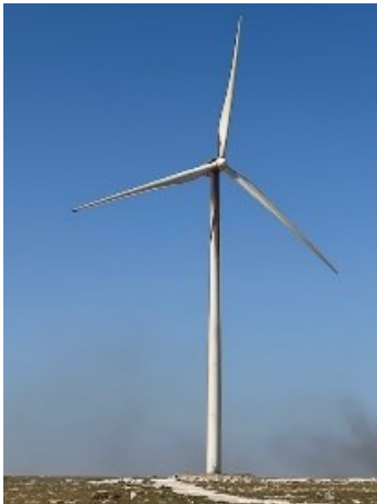
Éolienne à Nouakchott
